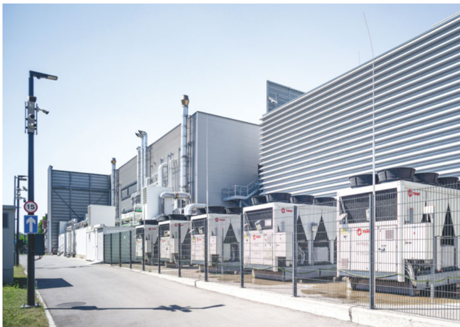
Fünf Wasserkühlmaschinen halten die Temperaturen im Equinix Rechenzentrum ZH5 auf unter 27 Grad Celsius.
