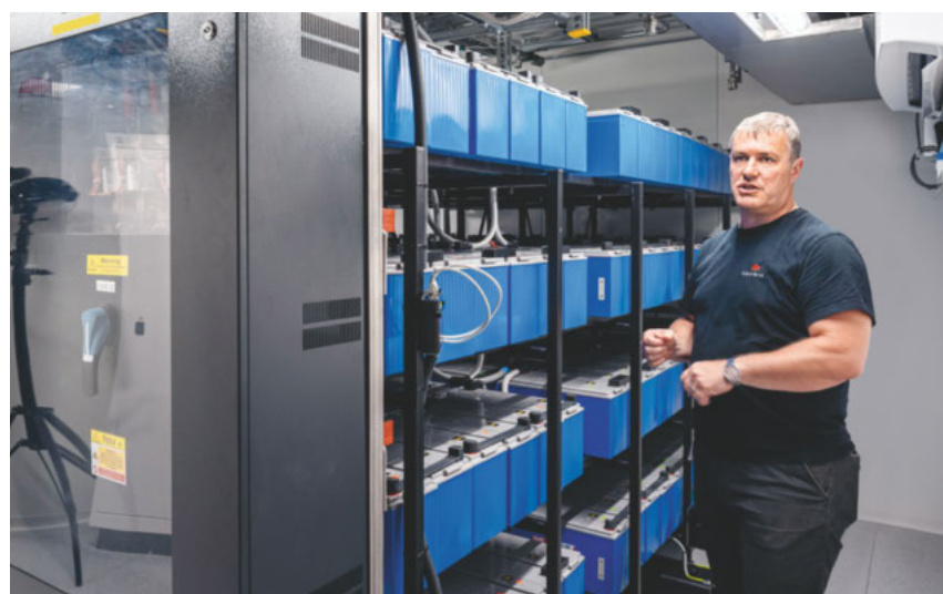
Bei einem Stromausfall läuft der Betrieb während 32 Stunden unter Vollast nahtlos weiter. Roger Beeler im Batterieraum der Notstromversorgung.
